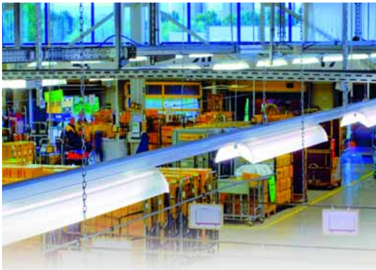
Die deutsche Post erwartet in Straubing, dank neuer Beleuchtung, ca. 60 Prozent weniger Stromverbrauch. (Foto: OSRAM)
